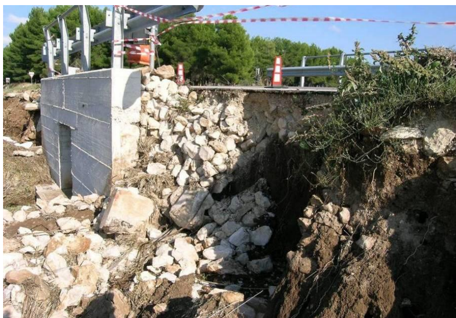
Fig. 4.1.24 Danni alle infrastrutture viarie (erosione del rilevato stradale) a seguito dello stesso evento delle fig. precedenti, a valle dell'area spietrata.
